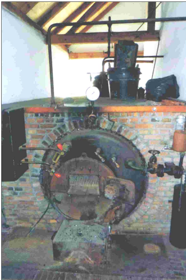
Der Dampfkessel ist das Herz der Anlage. Geheizt wurde mit Kohle.
